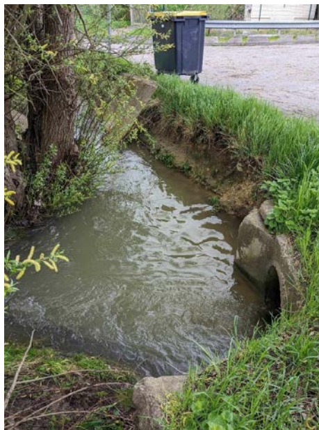
Berges endommagées à Quincy-Voisins
