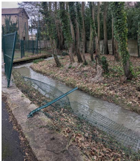
Berges endommagées à Villenoy
