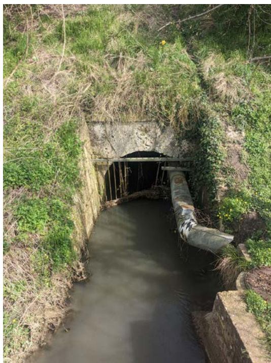
Grilles endommagées à Villenoy
