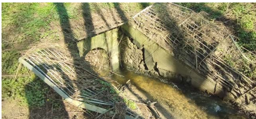
Grilles endommagées à Quincy-Voisins
